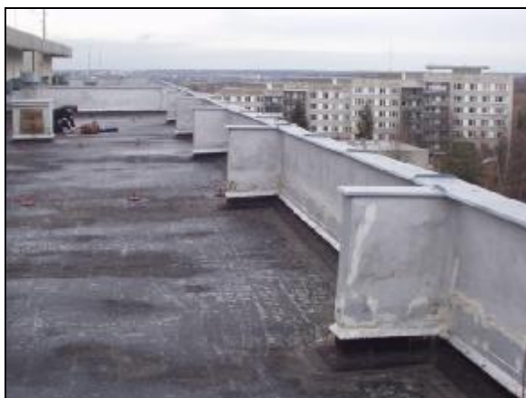
foto /12/ Ztužující atiky
