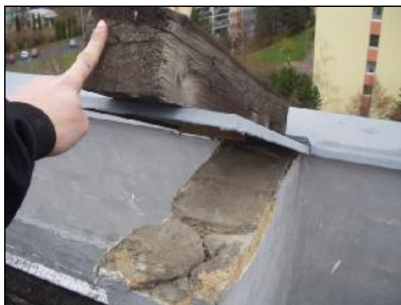
foto /13/ Održené oplechování atiky
