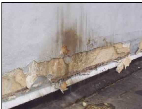
foto /15/ Trhlina, opadaná omítka
