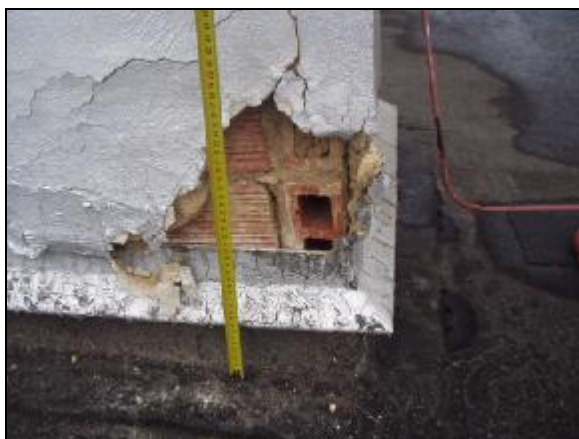
foto /22/ Opadaná omítka tlumící komory
