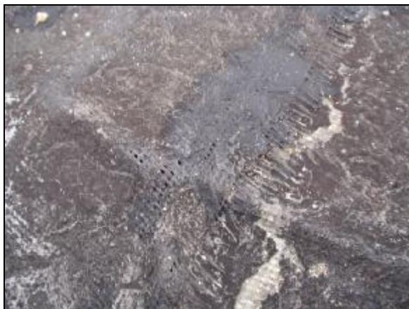
foto /8/ Obnažená výztužná vložka
