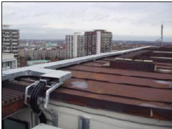
foto /35/ Vedení mobilního operátora
