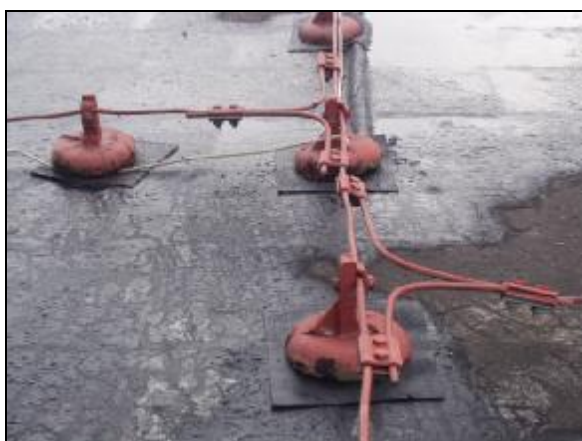
foto /37/ Vedení ocelového lana bleskosvodu
