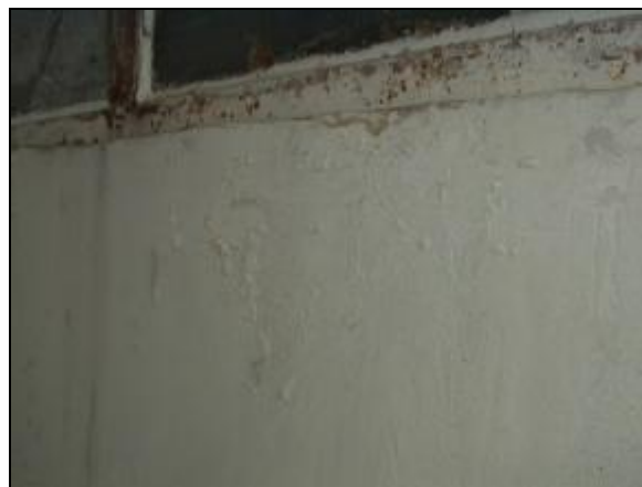
foto /31/ Vlhkostní poruchy pod copilitovou stěnou
