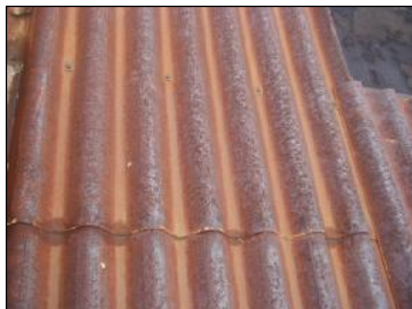
foto /27/ Koroze vlnitého plechu
