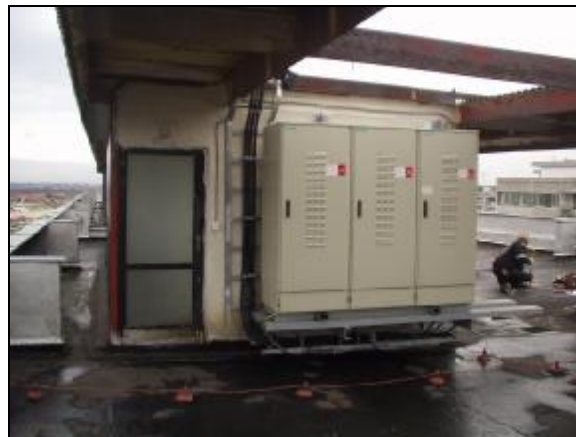
foto /36/ Rozvodová skříň mobilního operátora
