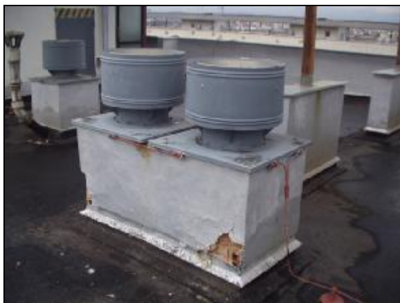
foto /20/ Tlumící komory VZT
