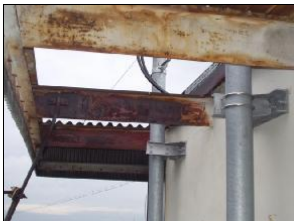
foto /28/ Koroze nosných profilů
